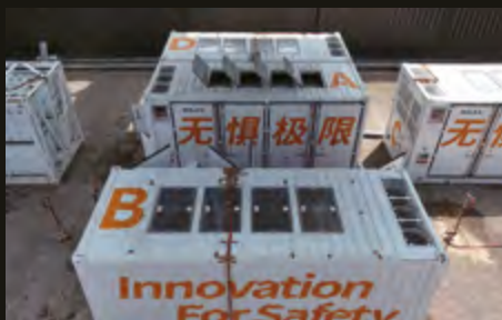
Container batteria DC in configurazione di test
