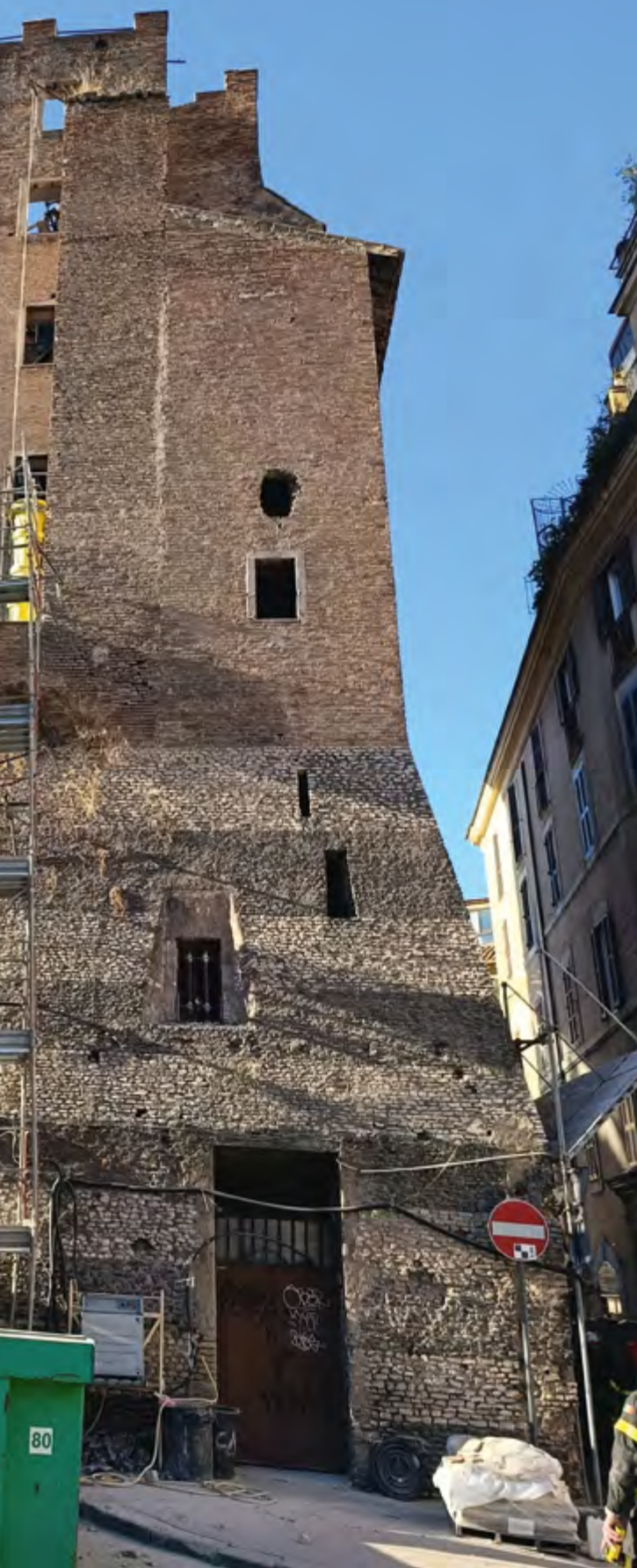
Vista d'insieme del prospetto interessato dal crollo
