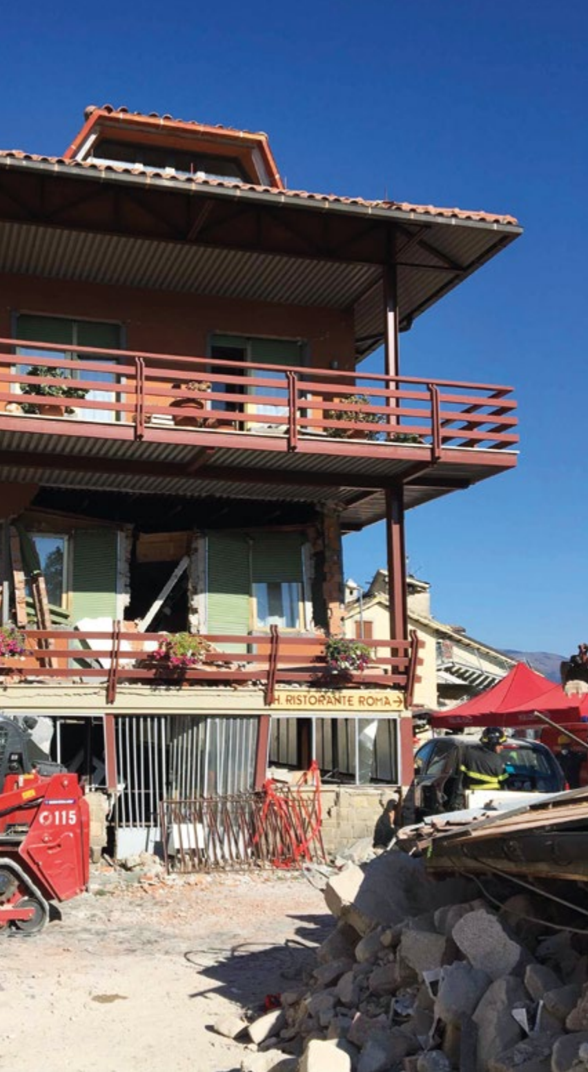
A sinistra, la struttura dell'hotel Roma fortemente danneggiata dal terremoto
